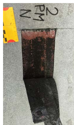
Trennfall b: Trennung zwischen Klebmasse der Bahn und Epoxid- harzoberfläche mit verbleibenden Klebe- masseresten auf der Unterlage
