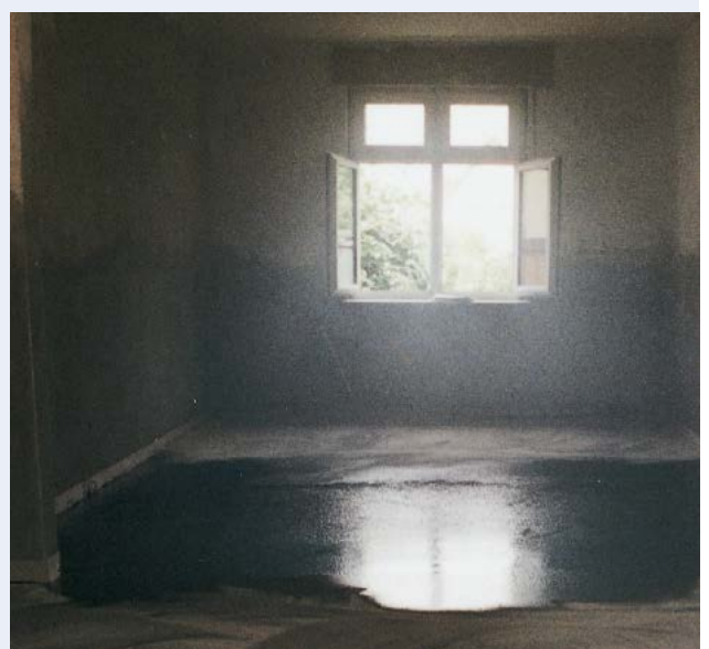
Unten: Durch Wasser zerstörte Holzbalkendecke Mitte/Unten: Einbau des Gussasphaltestrichs
