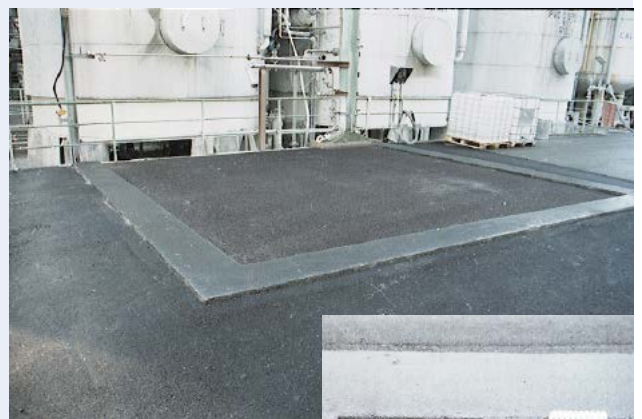
Umschlagfläche aus Gussasphalt in einem Kölner Chemiewerk. Detailaufnahme: Aufkantung aus 4 cm Gussasphalt auf der Umschlagfläche
