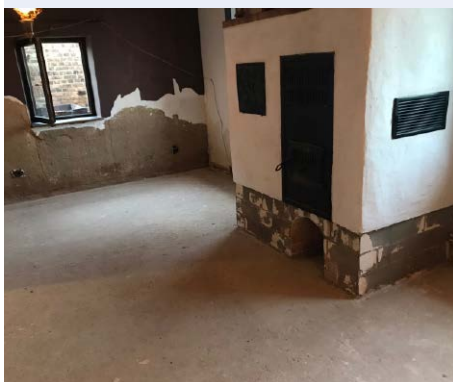
Vom Hochwasser beschädigte Fußböden und Sockelputz wurden entfernt
